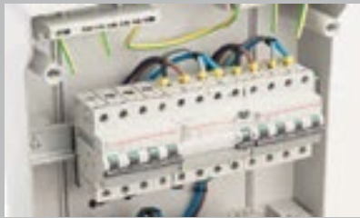
Posibilidad de instalar terminales de neutro y tierra Ready to install the terminal blocks for neutral and earth connection
